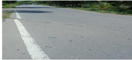
Gambar 6. Retak Memanjang (Dokumentasi Lapangan 2020)
