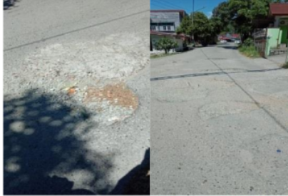
Gambar 5. Kerusakan Jalan Lubang (Dokumentasi Lapangan 2020)
