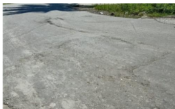
Gambar 8. Kerusakan kegemukan (Dokumentasi Lapangan 2020)
