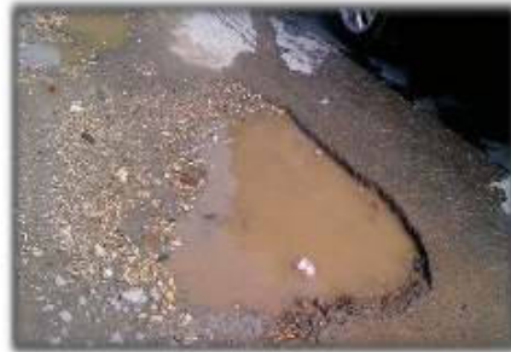
Gambar 3 Kerusakan Jalan di Sisi Jalan Ardipura II Polimak
