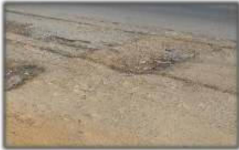
Gambar1. Kerusakan Jalan di Ruas Jalan Raya Sentani
