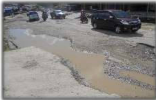
Gambar 2 Kerusakan Jalan di Kelapa Dua Entrop
