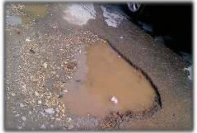
Gambar 3 Kerusakan Jalan di Sisi Jalan Ardipura II Polimak
