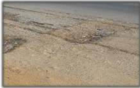
Gambar1. Kerusakan Jalan di Ruas Jalan Raya Sentani
