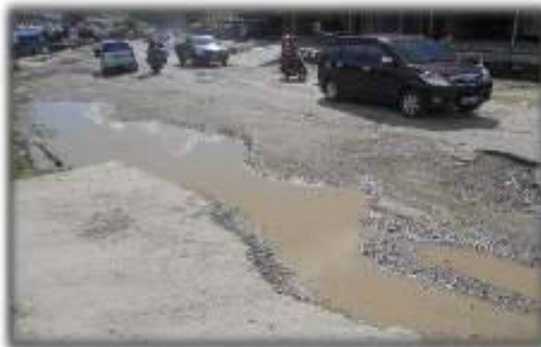
Gambar 2 Kerusakan Jalan di Kelapa Dua Entrop
